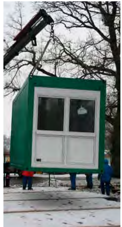
Das erste Teil für Alien World schwebt am Kranhaken. Insgesamt wurden am 11. Februar zehn Container an Ort und Stelle gebracht.
